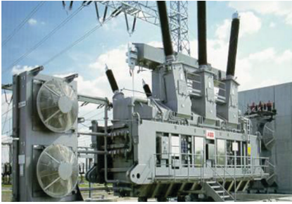
FIGURA 1. Foto do transformador para linhas de alta tensão.
